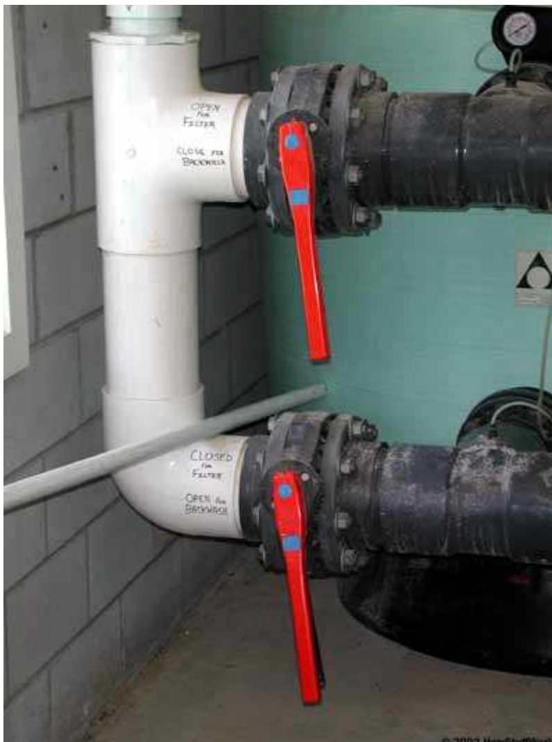
管理员转动大把手调整管道阀门，可改变水流方向，进行反冲洗。
