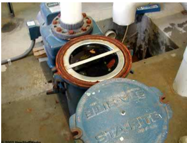
滤网篮位于水泵正前方。
