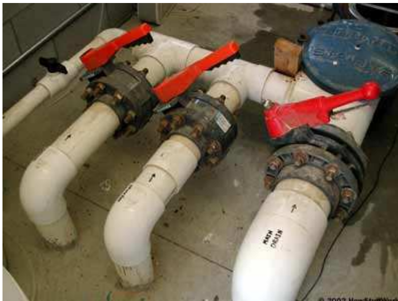
主排水管、撇渣器和真空口的水管都连接到抽吸系统。
